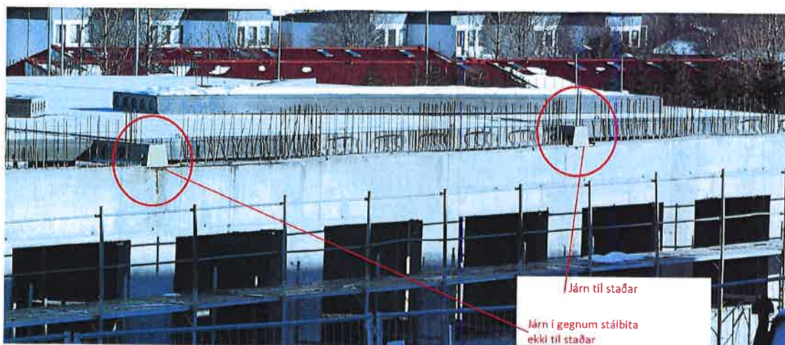
Mynd nr. 22: Stálbitar ófestir við útveggi hússins á fleiri stöðum í húsinu.
