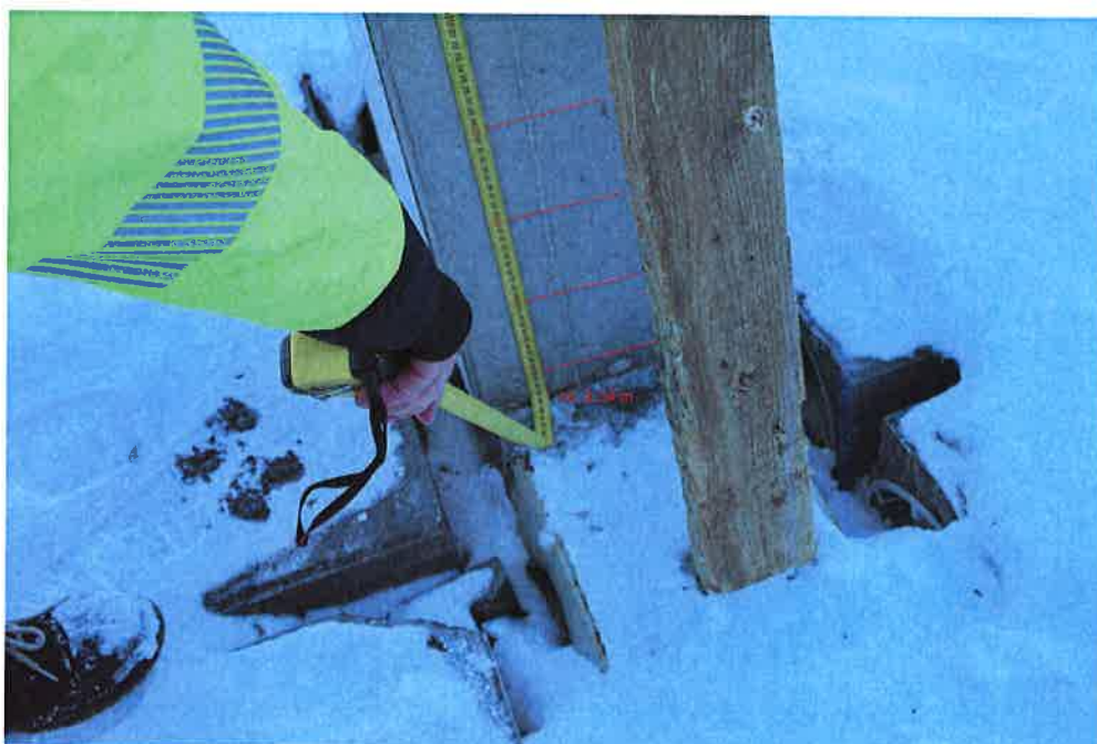
Mynd nr. 13: Mæling á annari súlu í 4 röð á slysstað sem steypst hefur verið í réttri hæð Hæð ca. 3.54 metrar
