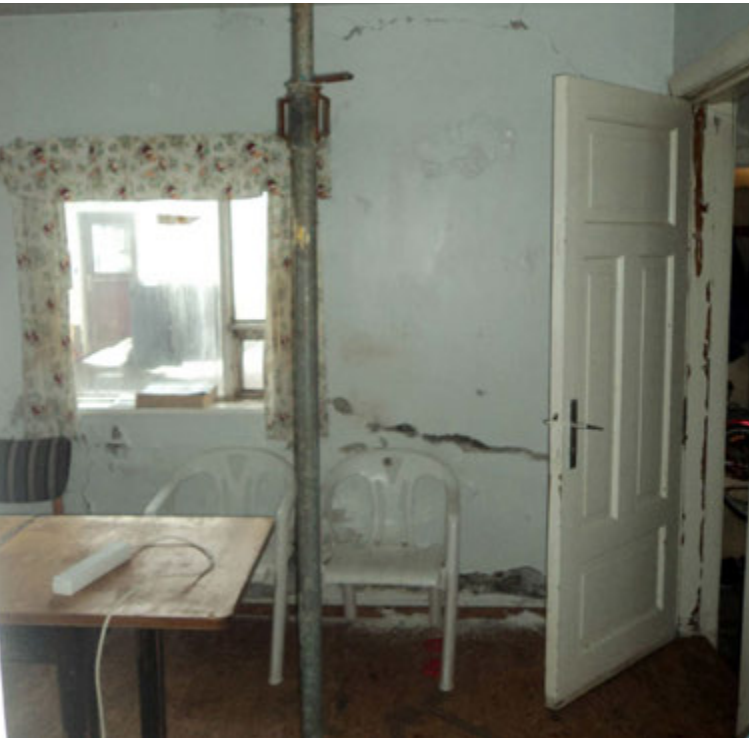
Eins og sjá má er húsið að Friðarstöðum illa leikið. Húsið er nú óíbúðarhæft en hér má sjá eldhúsið.
