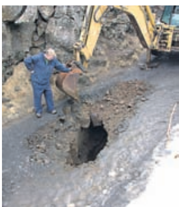
JARÐFALLIÐ Vegurinn niður Almagnagjá liggur ofan á uppfyllingu og jarðskjálftar losuðu um steinana. Vatnsagi gróf síðan undan veginum og skapaði jarðfallið.
