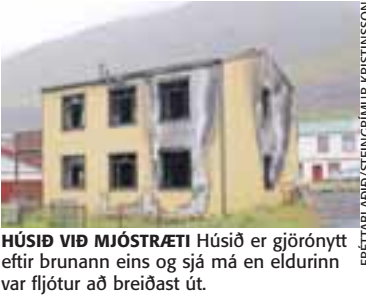
HÚSIÐ VIÐ MJÓSTRÆTI Húsið er gjörónytt eftir brunann eins og sjá má en eldurinn var fljótur að breiðast út.
