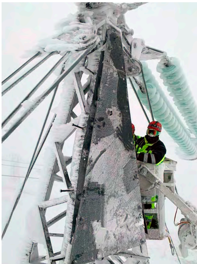
„Við lærðum margt af þessu óveðri og stöndum nú ári síðar mun betur að vígi komi annað eins áhlaup,“ segir Guðmundur Ingi. Hér er verið að vinna við Fljótssalslínu.
